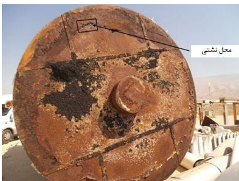
شکل ۹- نشتی مشاهده شده بر روی کف مخزن
